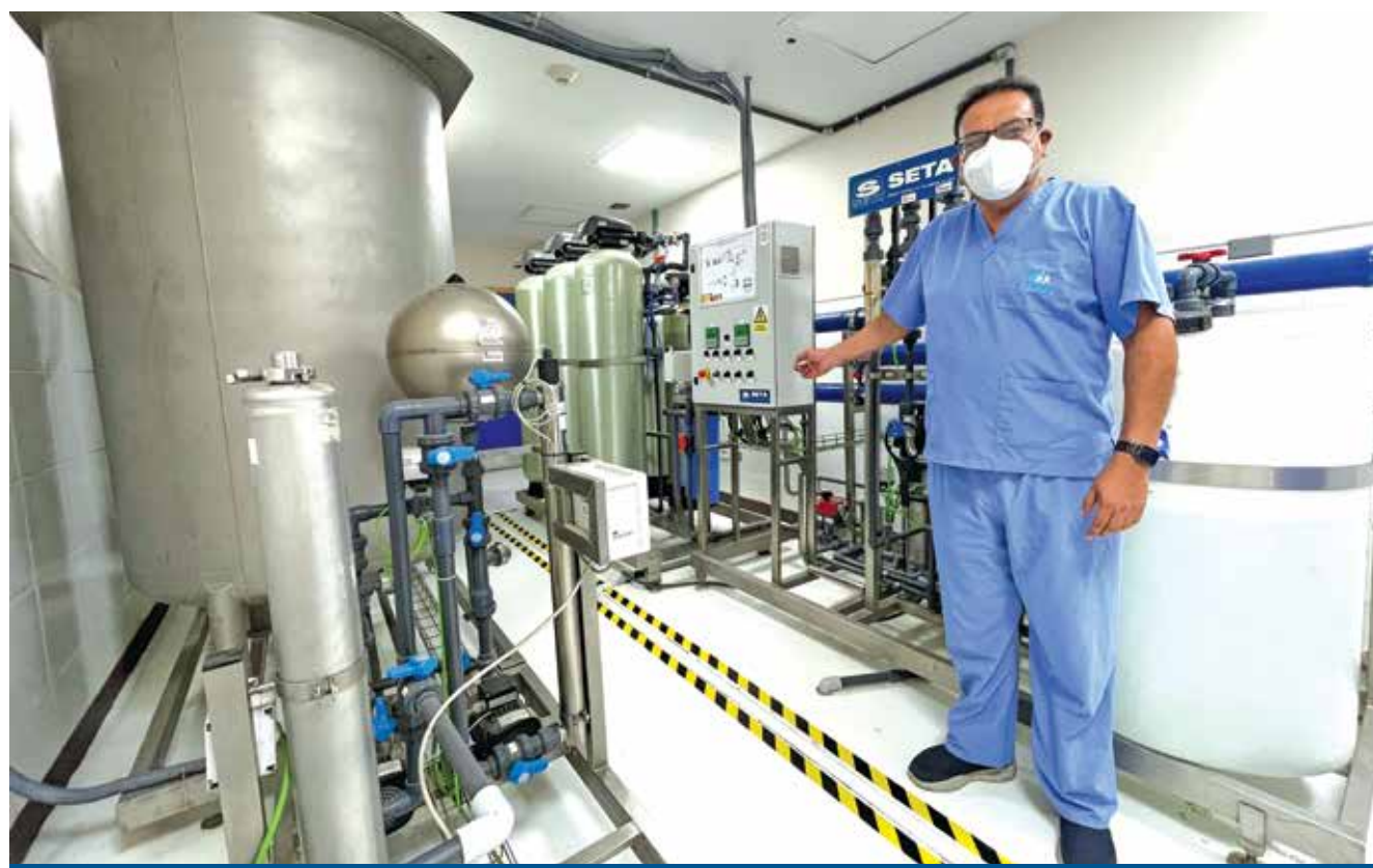
Planta tratamiento de agua para hemodiálisis.
